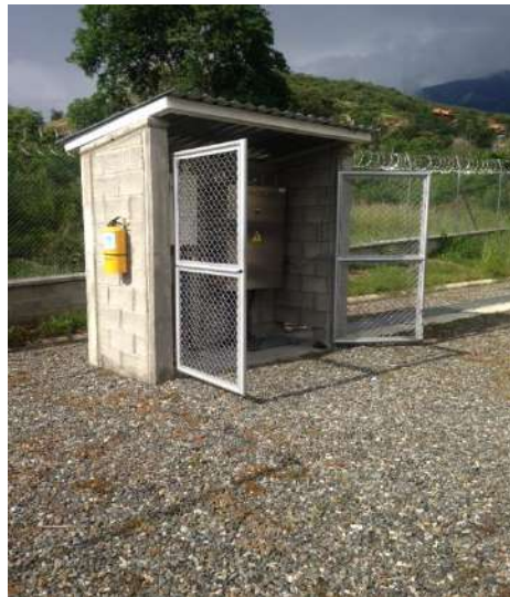
Muro en U para alojar tanto el tablero de potencia como el tablero de gestión y control de comunicaciones
