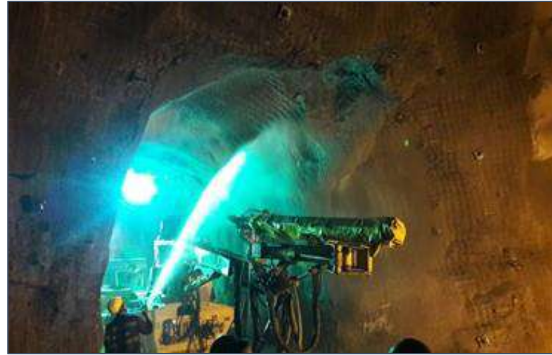
Tratamientos en zona de intersección de la galería auxiliar con galería G3
