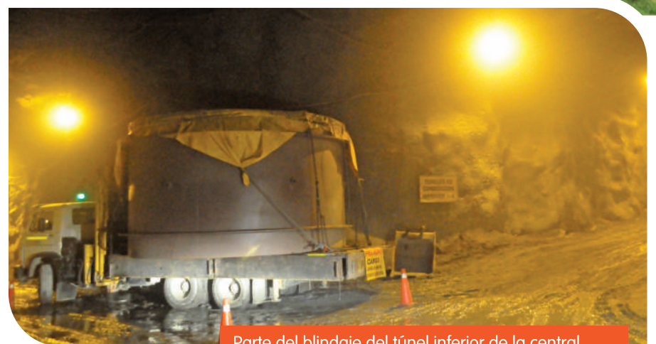
Parte del blindaje del túnel inferior de la central, ya en el sitio de montaje, listo para ser descargado.
