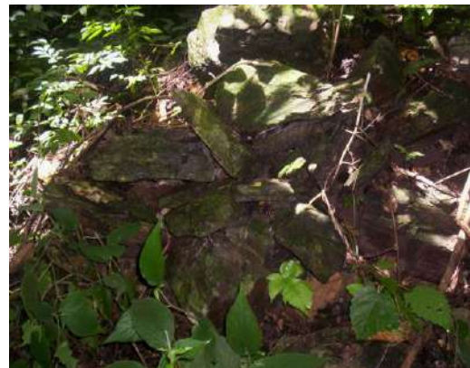
Foto 2. Vallado derrumbado Guimaral
