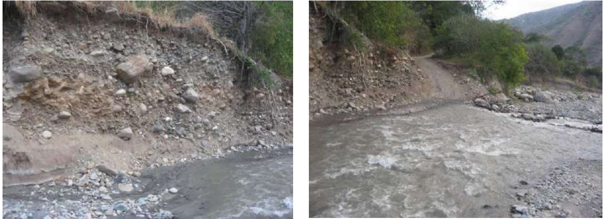
Fotografía 3.1.3.32 Estación Quebrada Juan García
