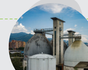
PTAR San Fernando
